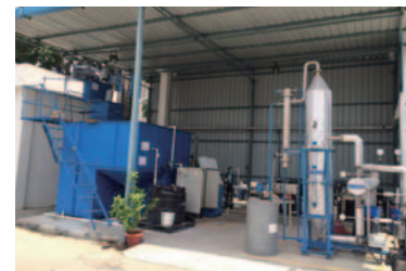
排水処理設備
