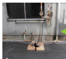
旧着色排水ピット (排水コック切り替え用)
