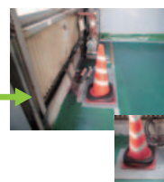
排水ピット移設 (液面計による自動発停)
