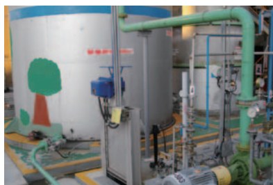
緊急時排水回収設備
