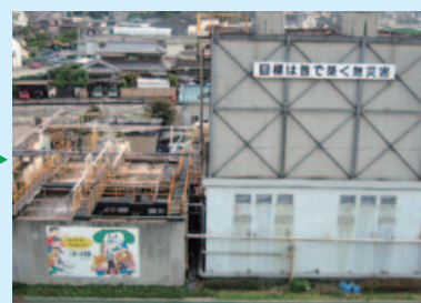
生物活性法廃水処理設備
