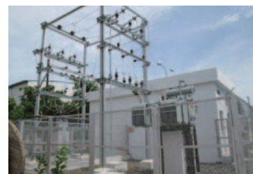
高圧受電設備
