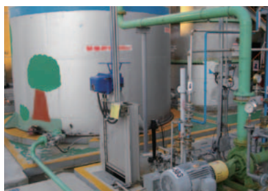
緊急時排水回収設備
