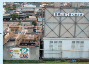
生物活性法廃水処理設備
