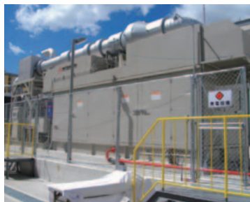
コージェネレーションシステム
