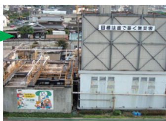
生物活性法废水処理設備
