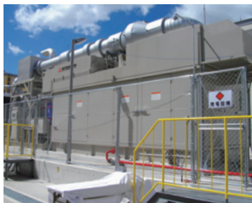
コージェネレーションシステム
