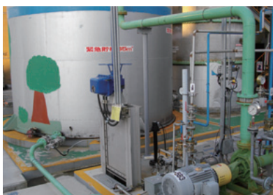
緊急時排水回収設備
