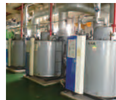
蒸気ボイラー
