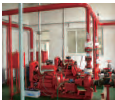
2台の消防加圧ポンプ
