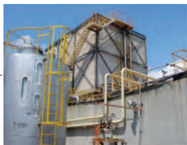
散水汙床(生物処理設備)
