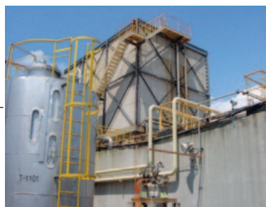
散水汙床(生物処理設備)
