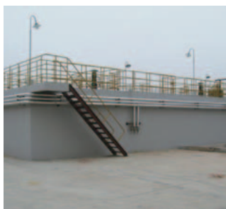
廃水処理設備
