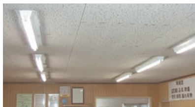
省エネタイプの照明器具を使用した事務所
