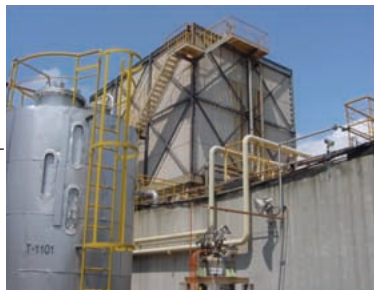
散水汙床 (生物処理設備)
