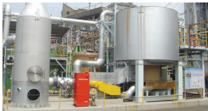
<工場排ガスの臭気・VOC対策(脱臭炉)>
