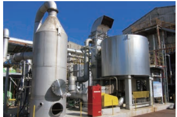
淀川工場の脱臭炉。PRTRの大気への排出量の抑制に寄与しています。
