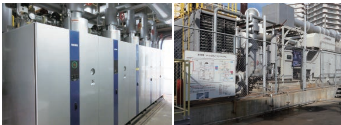
高効率設備に更新された淀川工場の蒸気ボイラー(左)とコージェネレーションシステム(右)。大気汚染物質の排出も適切に管理しています。
